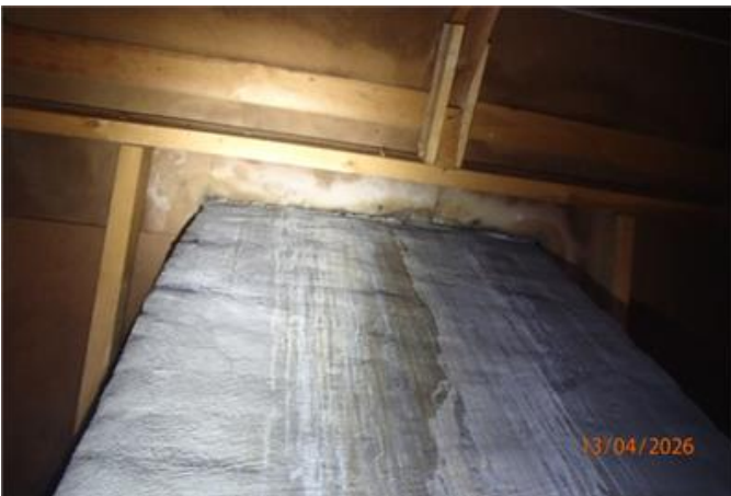
Missfärgningar noterades på masoniten runt skorsten. kontrollera orsak samt omfattning.
