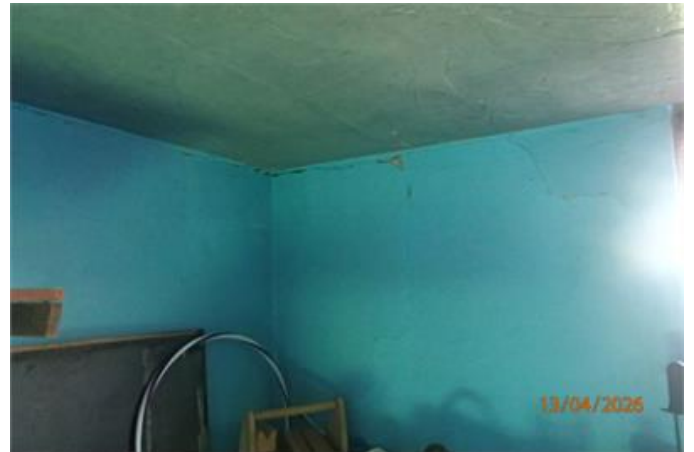
Sprickor noterades i källaren.
