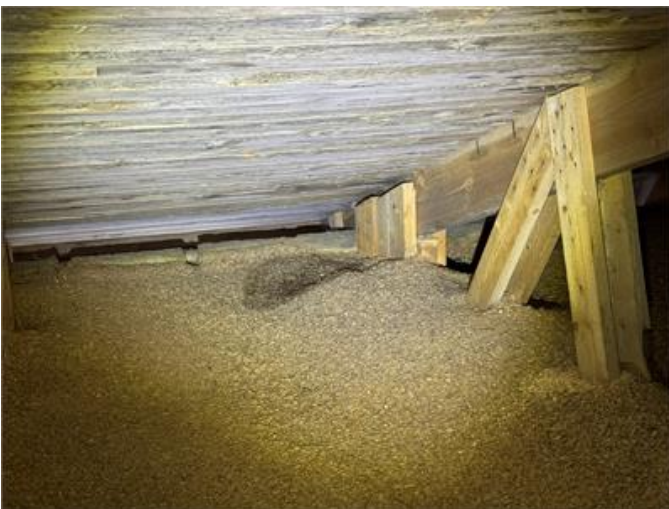
Fuktfläck på underlagstak och isolering i garagets vind.
