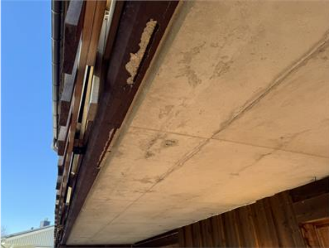
Sprickor och synlig armering under balkong.
