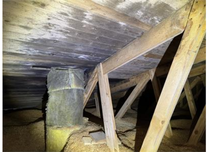
Fuktfläckar på underlagstak i vindsutrymme.
