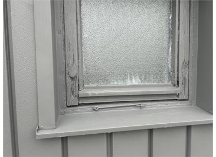
Fönster: Röttskadat fönster noteras vid balkong.
