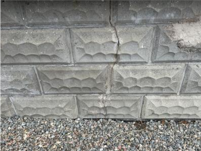
Sockel: Sprickor förekommer.
