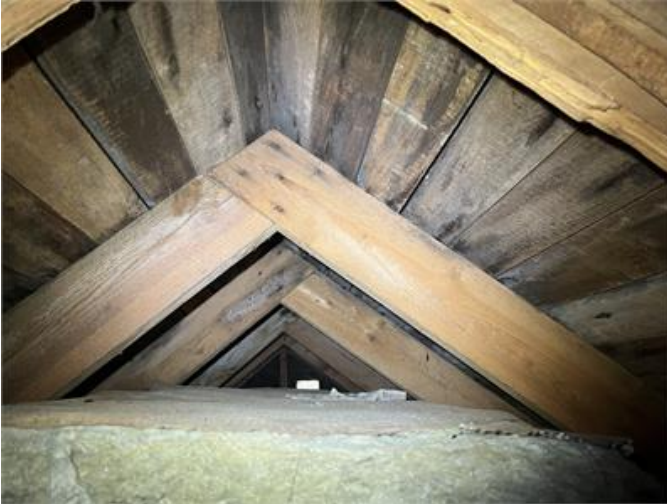
Mikrobiell påväxt på vinden.
