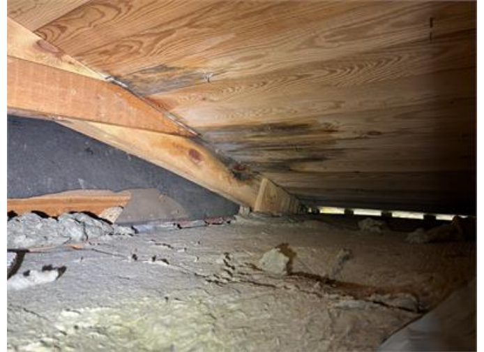
Fuktfläckar förekommer på vind över tillbyggd del.
