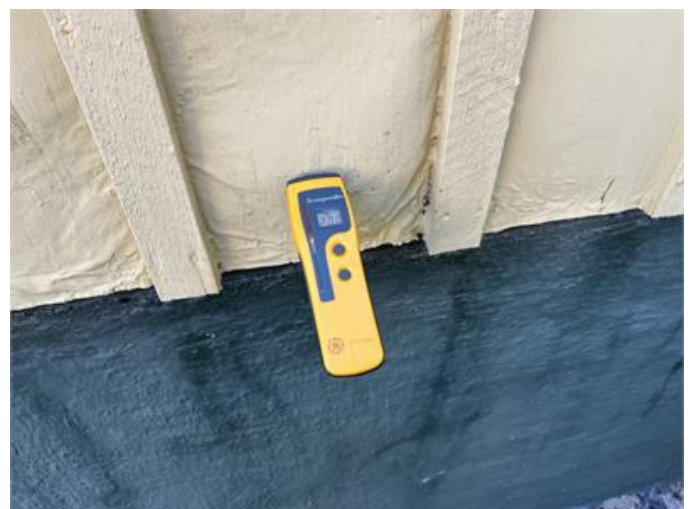
Blåsor/förhöjda fuktvärden i masonitskivor på fasaden.
