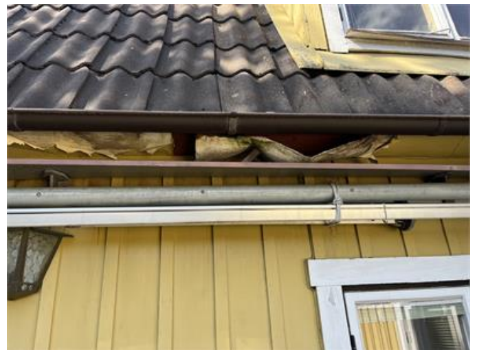
Fuktgenomslag/takfotsskivor som släppt.
