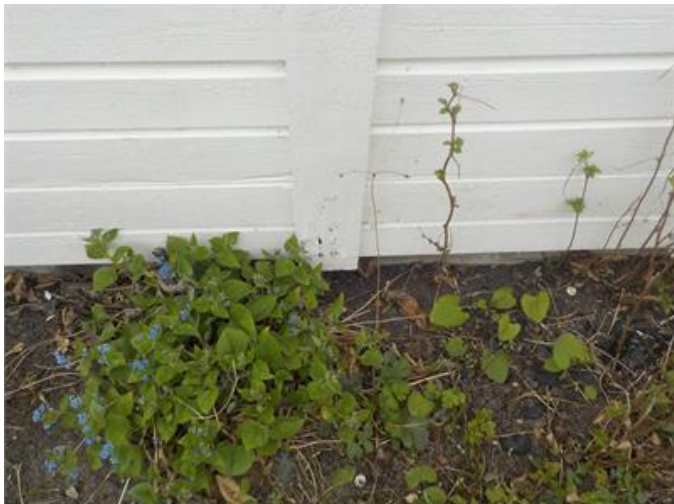
Rötskador i nederdel fasadpanel.
