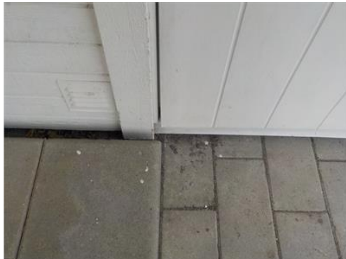
Förrådsdörren är skev/ansluter bristfälligt.
