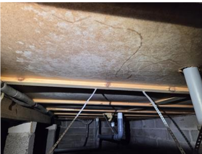
Mikrobiell påväxt på blindbotten
