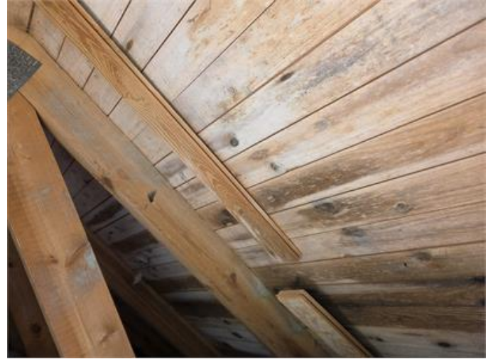
Mikrobiell påväxt på underlagstak.
