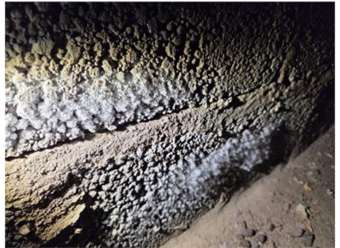
Kalkutfällningar på grundmurens insida.
