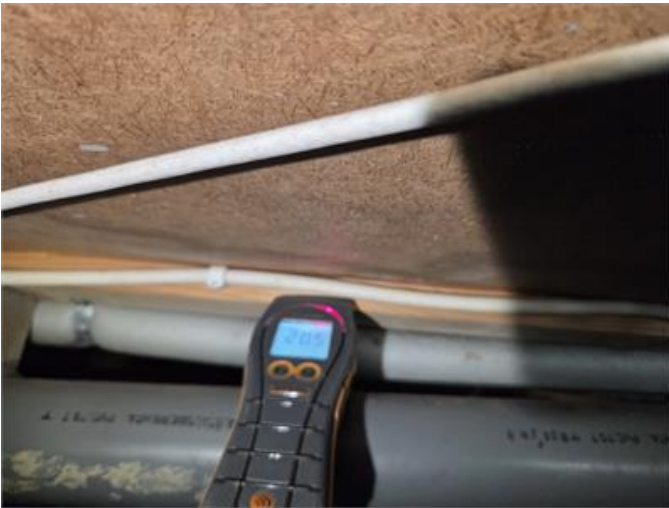
Förhöjd fuktkvot mättes upp i krypgrund.
