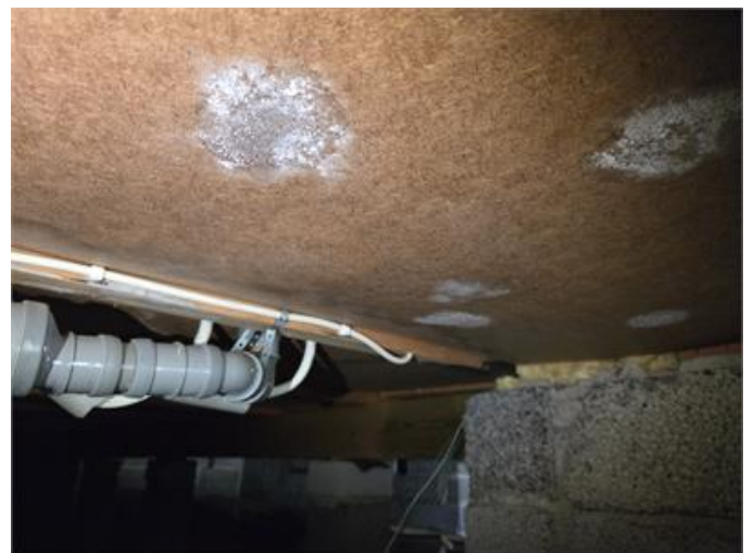
Mikrobiell påväxt på blindbotten
