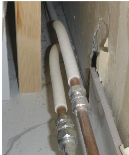
Uppvik saknas delvis på vägg bakom värmepumpen
