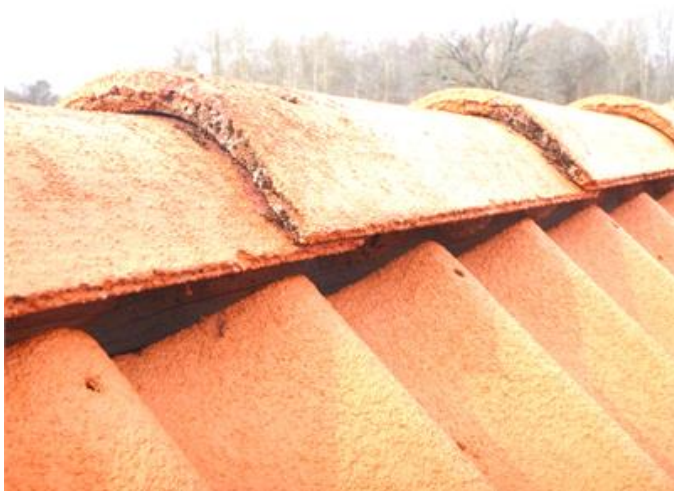
Avsaknad av överlapp mellan nock och takpannor
