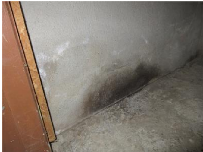
Fuktgenomslag i förråd 2
