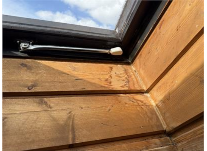
Fuktfläckar invid takfönster, torrt vid besiktningstillfället
