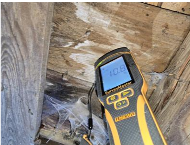
Nockvind: Fuktfläckar noteras, fuktkvotsmätning utförd utan anmärkning.
