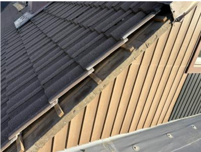
Bilden visar exempel på brister i taktäckningen (vindskiva/plåt saknas).
