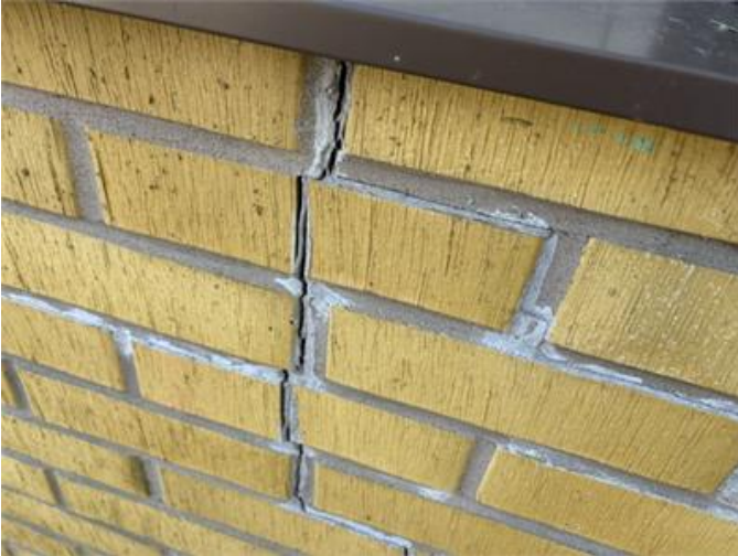
Bilden visar exempel på spricka i tegelfasaden.
