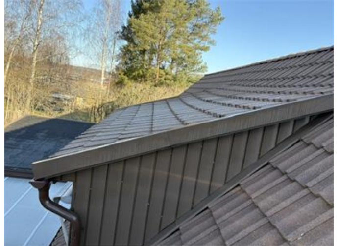
Bilden visar exempel på brister i taktäckningen (takkupans tak bågner kraftigt).
